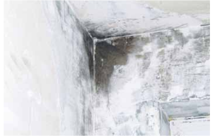
Schimmel sieht nur nicht schlimm aus, sondern kann auch gesundheitsschädlich sein Foto: Baufan
