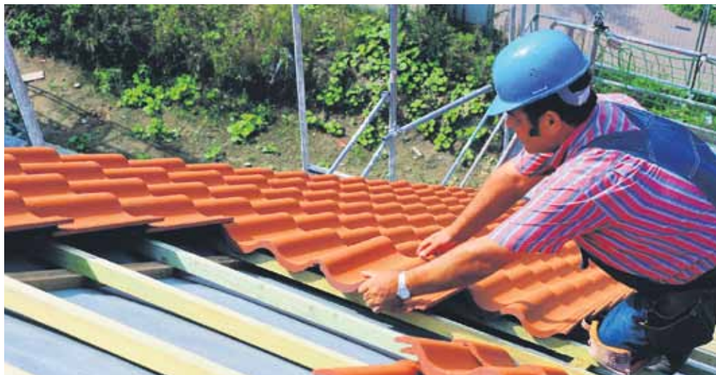
Im Zuge des Ausbaus kann es sinnvoll sein, über eine Neueindeckung des Daches nachzudenken.
